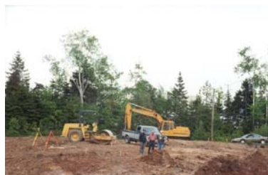
Photo de Yvonne McLaughlin. Début des travaux durant la semaine du 5 juin 2000. On aperçoit George Caissie, administrateur de la paroisse, au milieu.
